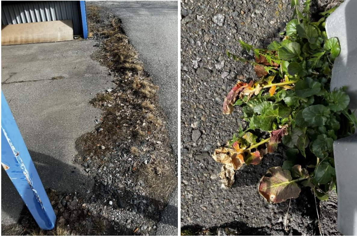
Figur 3: Vegetasjon på asfaltdekte arealer. Til høyre vokser vinterkarse (SE) i en asfaltsprekk.
