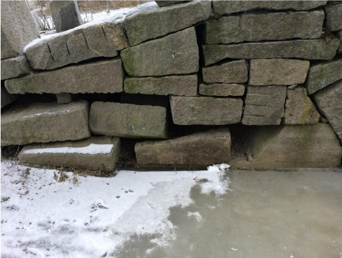
Figur 7: Skader på Steinhvelvsbroen. Bildet er tatt 15.02.2017.
