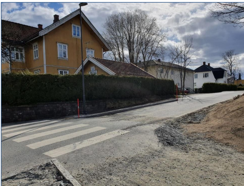
Figur 8 Gangfelt over Skoleveien ved kryss med Sagaveien, i retning sør/sør-vest. Skoleveien er innsnevret på grunn av dårlig sikt i krysset (bilde: Sweco Norge AS)
